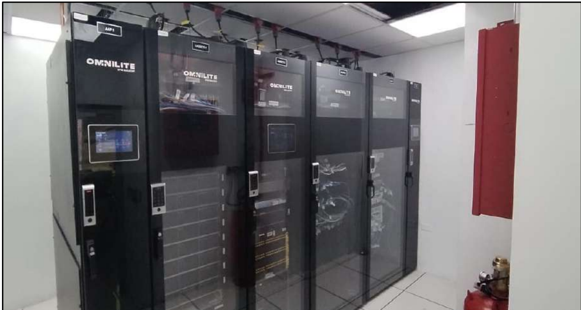
Data Center del INPE, sede principal.
