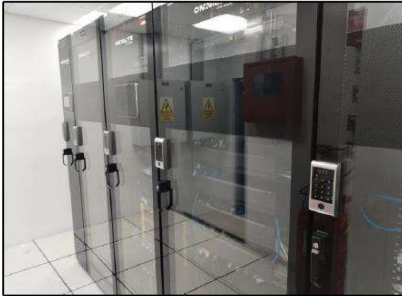
Con el moderno Centro de Datos se fortalece la seguridad de la información institucional
